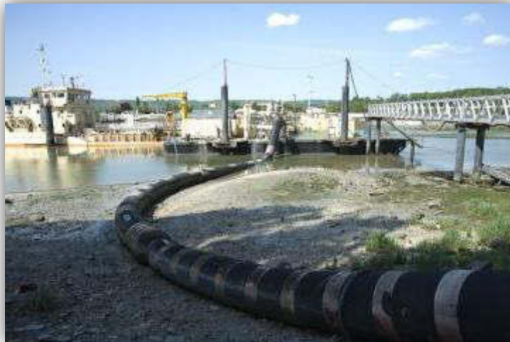
Conduite flottante reliant une drague à la rive
