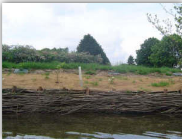
Tressage en pied de berge et géotextile complétant la protection en arrière de l'ouvrage
